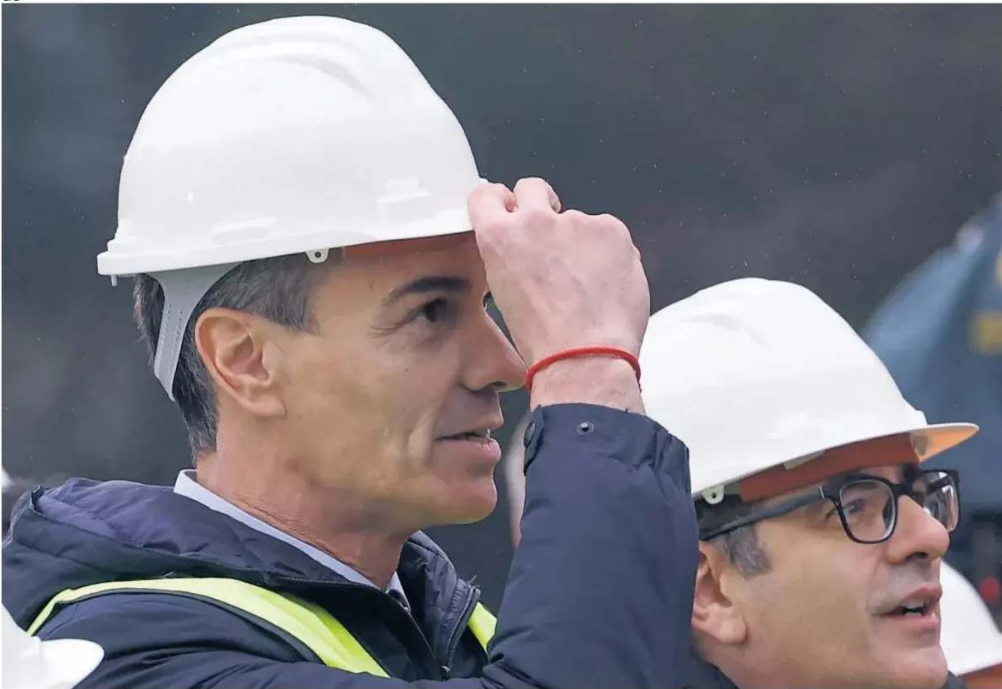
El presidente del Gobierno, Pedro Sánchez, junto al ministro de Justicia, Félix Bolaños, durante la demolición de los cuarteles de Campamento (Madrid) el pasado enero
